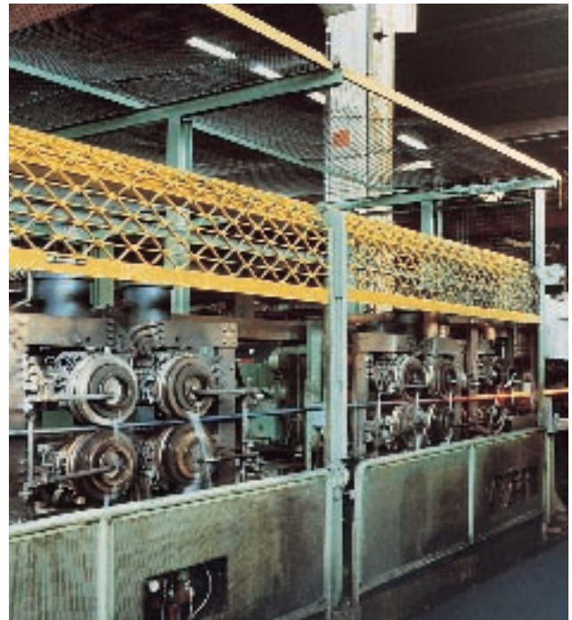
Erwärmungsgerüste einer Konti-Walzanlage Heating stand of a continuous rolling plant
